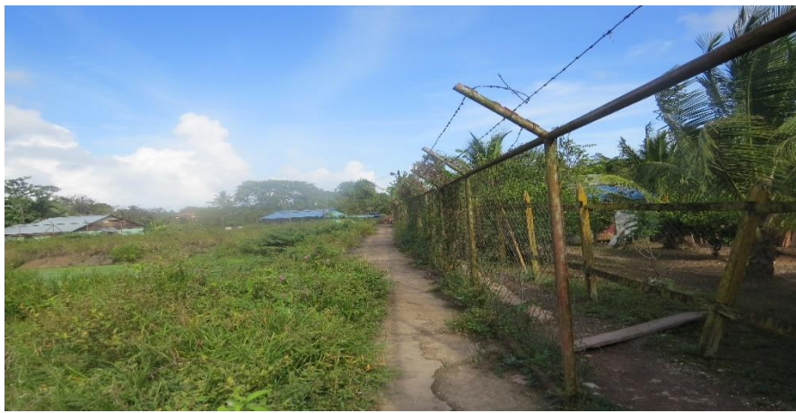
Ilustración 13. Cerco perimetral de las pilas de oxidación en mal estado.
