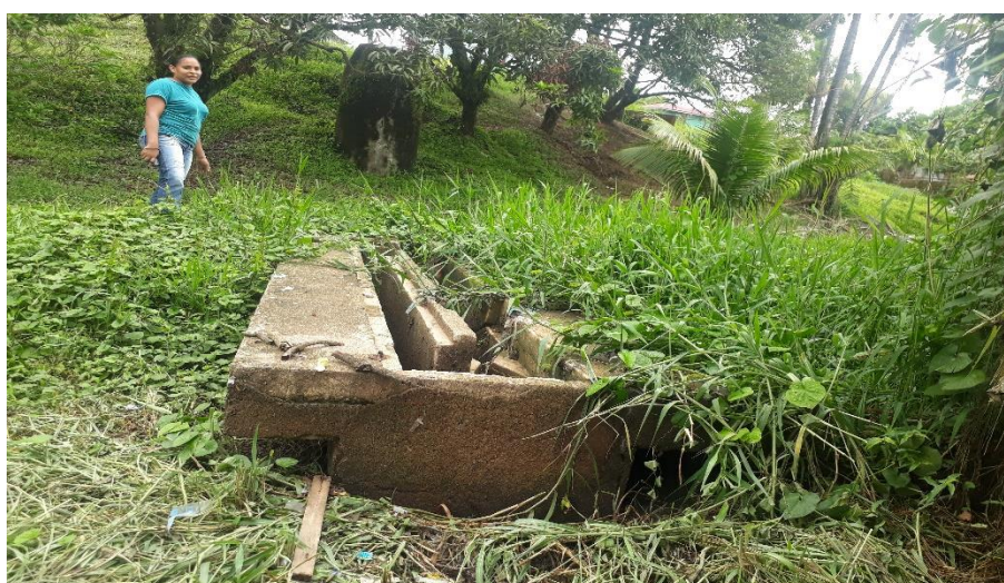
Ilustración 14. Inicio del sistema de drenaje de las pilas de oxidación en su punto de salida.
