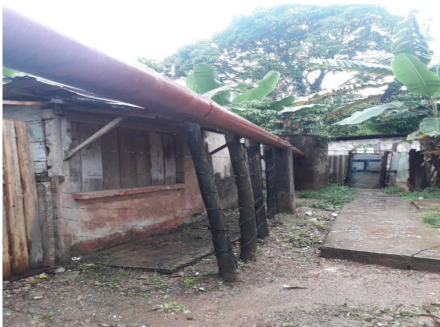
Ilustración 15. Tuberías de drenaje de las aguas residuales provenientes del hospital, tramo colgante.
