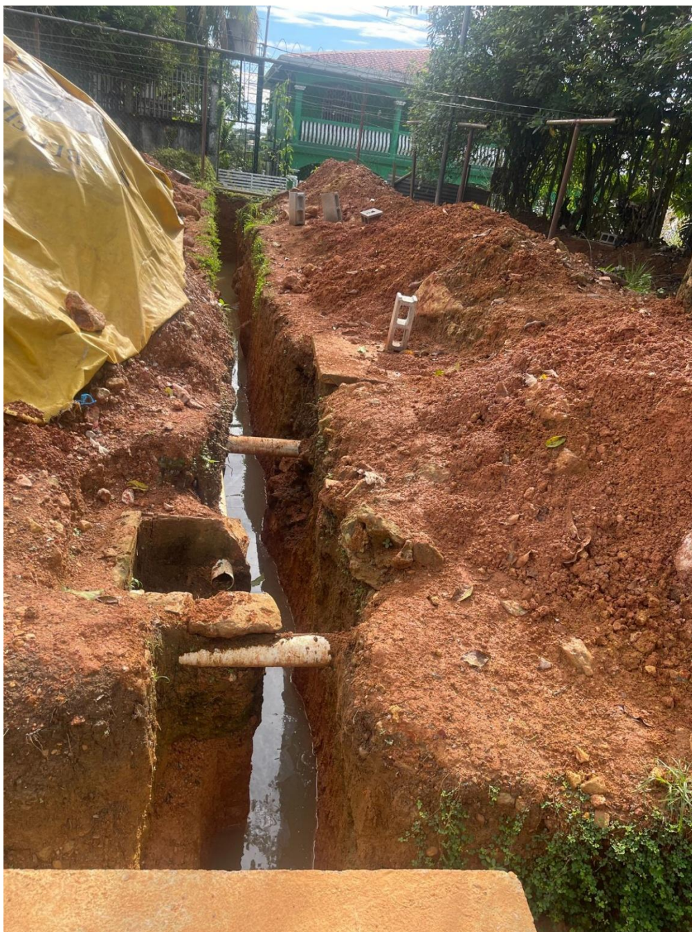
Figura 16. Funcionamiento de la fosa séptica del internado de BICU como caja de registro y descarga de efluentes hacia el exterior del sistema.
