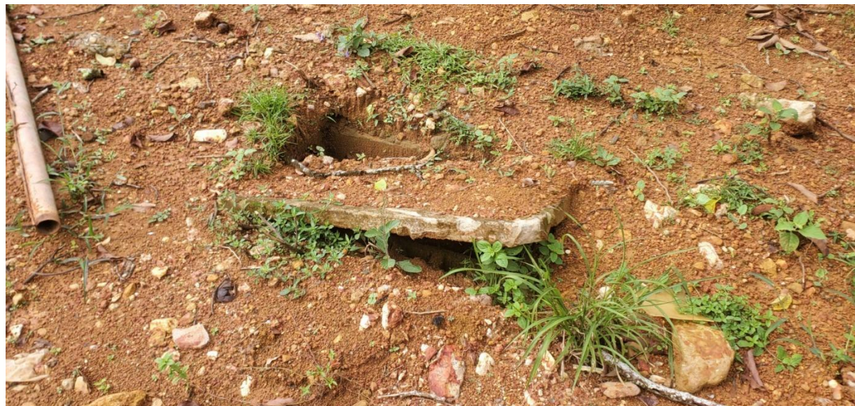
Figura 18. Evidencia del punto de descarga del sistema séptico existente hacia el exterior del área del internado de BICU.
