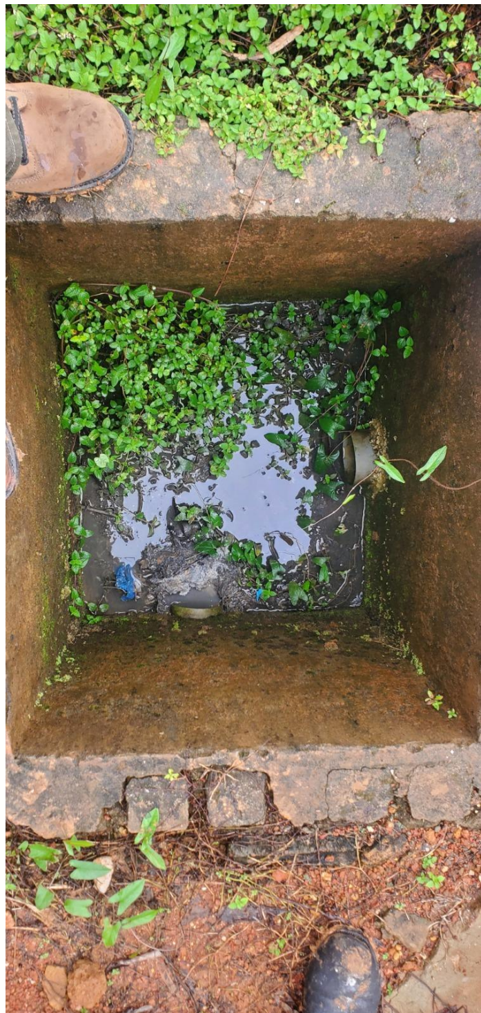
Figura 19. Caja de registro asociada al sistema séptico existente del internado de BICU con acumulación de efluentes y vegetación interna.
