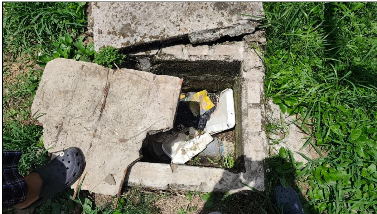
Figura 22. Estado físico previo mantenimiento de una caja de registro asociada al sistema séptico existente del internado de BICU.
